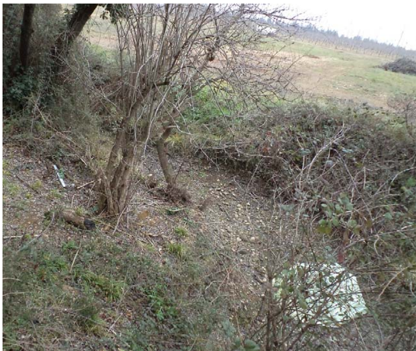
Figure 16 Arbres dans le lit mineur favorisant les embâcles à l'amont de l'emplacement prévu pour le déversoir
